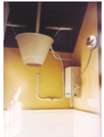
Chuveiro com misturador de água quente e fria
